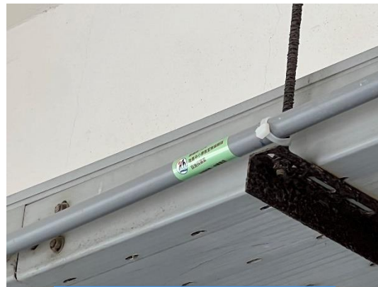
管路識別標示
