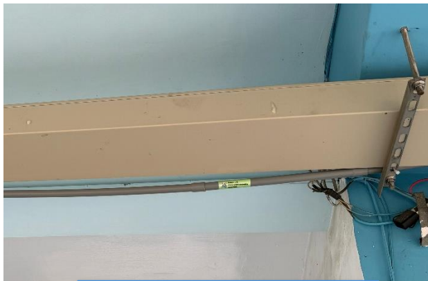
室外裸線配管保護
