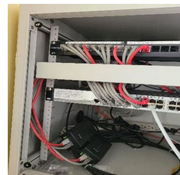
增補PoE供電設備
